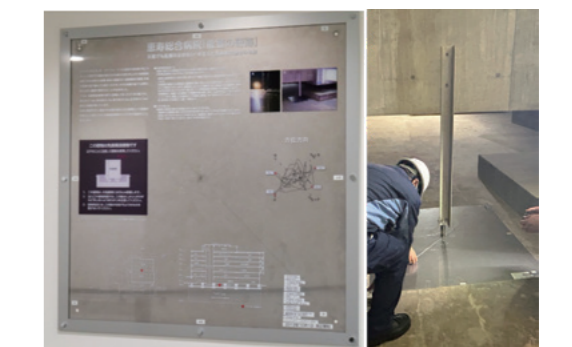
地下の免震層にある記録板「ケガキ板」には、40cmほどの地震で動いた跡(引っ掻き)が記録されていた。病院内の通路にはその記録が掲示されている
